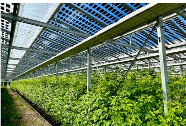
▭ Bild 3: „Insolagrín“ der Firma Insolight: semi-transparente bifaziale Module in Verbindung mit Kulturschutznetz und beweglichem Reflektionsschirm (Foto: Insolight)
