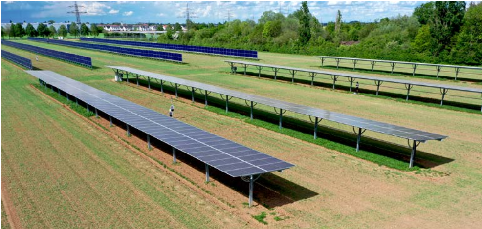
▭ Bild 7: Bodennahes einachsig nachgeführtes System der bayerischen Staatsgütern in Grub zu Forschungszwecken (Foto: Malte Stöppler, TFZ)
