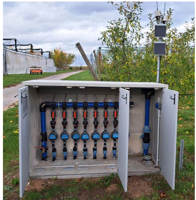
✔ Bild: Eine von 20 Verteilerboxen mit je acht ansteuerbaren Bewässerungssträngen (Foto: Alexander Zimmermann)
