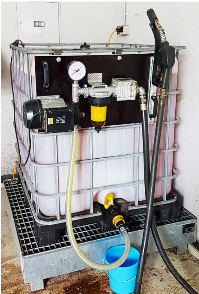
▭ Bild 3: Eigenverbrauchs-Tankstelle für Pflanzenölkraftstoff mit Förderpumpe, Filter und Zapfpistole
